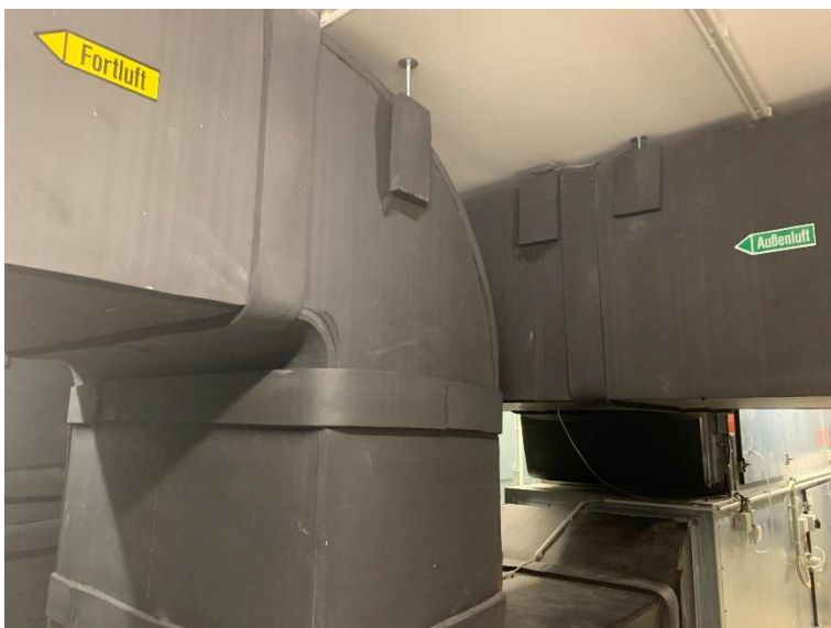
Abbildung 5 Blick in die Lüftungsanlage im Obergeschoss Altbau (© Foto: Dr. Ralf Müller)
