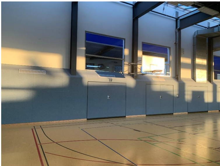
Abbildung 8 Ansaugung Abluft Südseite unten (© Foto: Dr. Ralf Müller)
